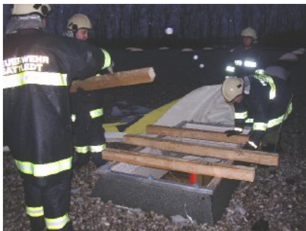
Die zerstörten Lichtkuppeln wurden mit Holzkantern und Planen wieder verschlossen
