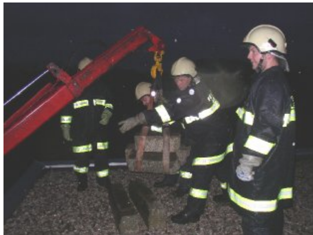
Mit dem Kran wurden die Materialien auf das Dach des Lagers der Firma Lutz gehoben
